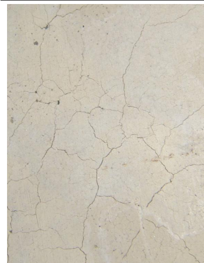
Рис. 1. Сетчатые трещины на поверхности бетонных кубиков, состав №1 через 18 суток твердения в камере нормального твердения
